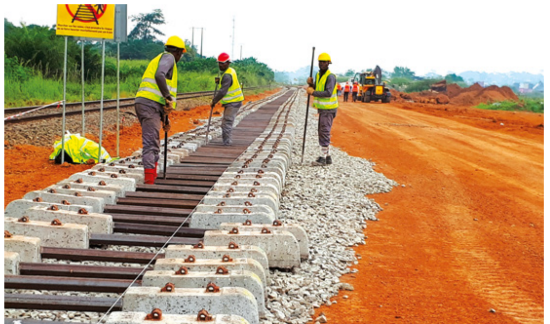
Réfection de la voie de chemin de fer dans le cadre du plan de remise à niveau de la Setrag.
