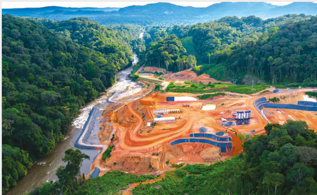
À gauche le premier batardeau achevé. Cette dérivation est une étape préalable permettant de travailler dans le lit de la rivière Mbei.
