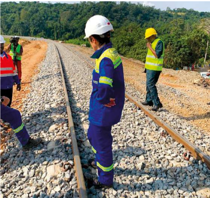
●●● Christel Bories sur les rails. 370 000 m 3 ont été déplacés en 23 jours à raison de 24h/24 et 7 j/7. Au final ce sont près de 500 000 m 3 qui seront déplacés. 150 personnes ont été mobilisées et 34 engins (pelles, bull, etc.).
