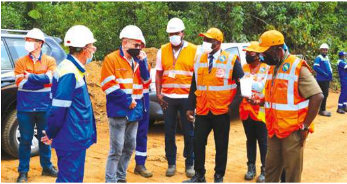
●●● Comité de suivi : président du comité de suivi, secrétaire exécutif de l'ARTF, représentants de la Setrag lors d'une mission inopinée de contrôle d'exécution des travaux du PRN et zones instables.
